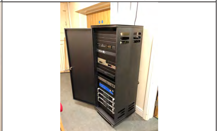
AV Rack situated in Store Room
