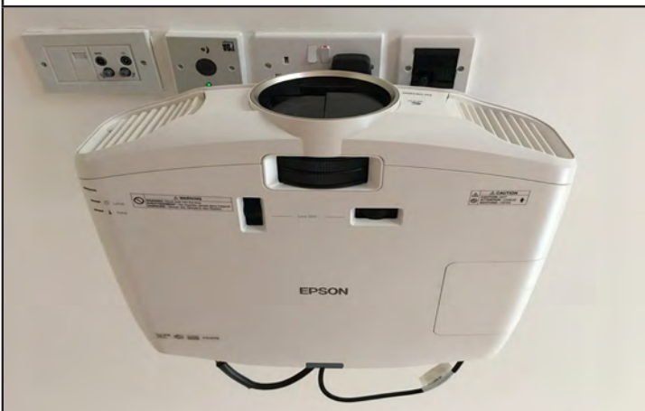
AV Projector mounted on ceiling
